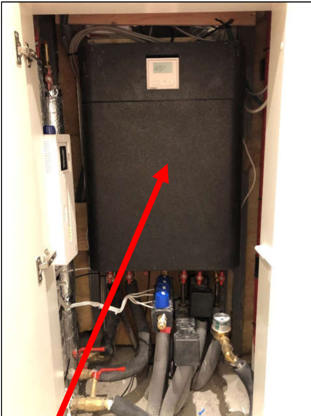
Fjernvarmeunit + fordelerrør til gulvvarme
